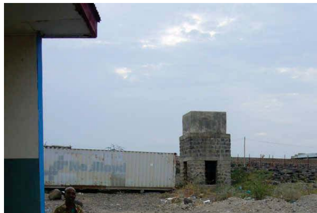
Figura 5. Depósito de agua y tuberías de conducción de parte de los edificios hospitalarios.
